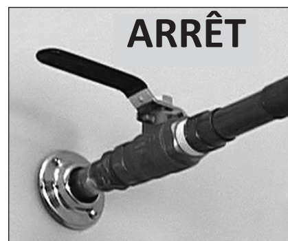
Figure 18. Arrivée d'eau froide fermée
