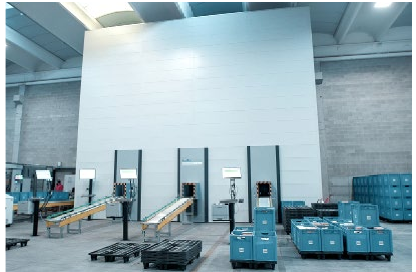
Ein Kardex Miniload-in-a-Box dient als einfacher Konsolidierungspuffer mit drei Behälteröffnungen.
