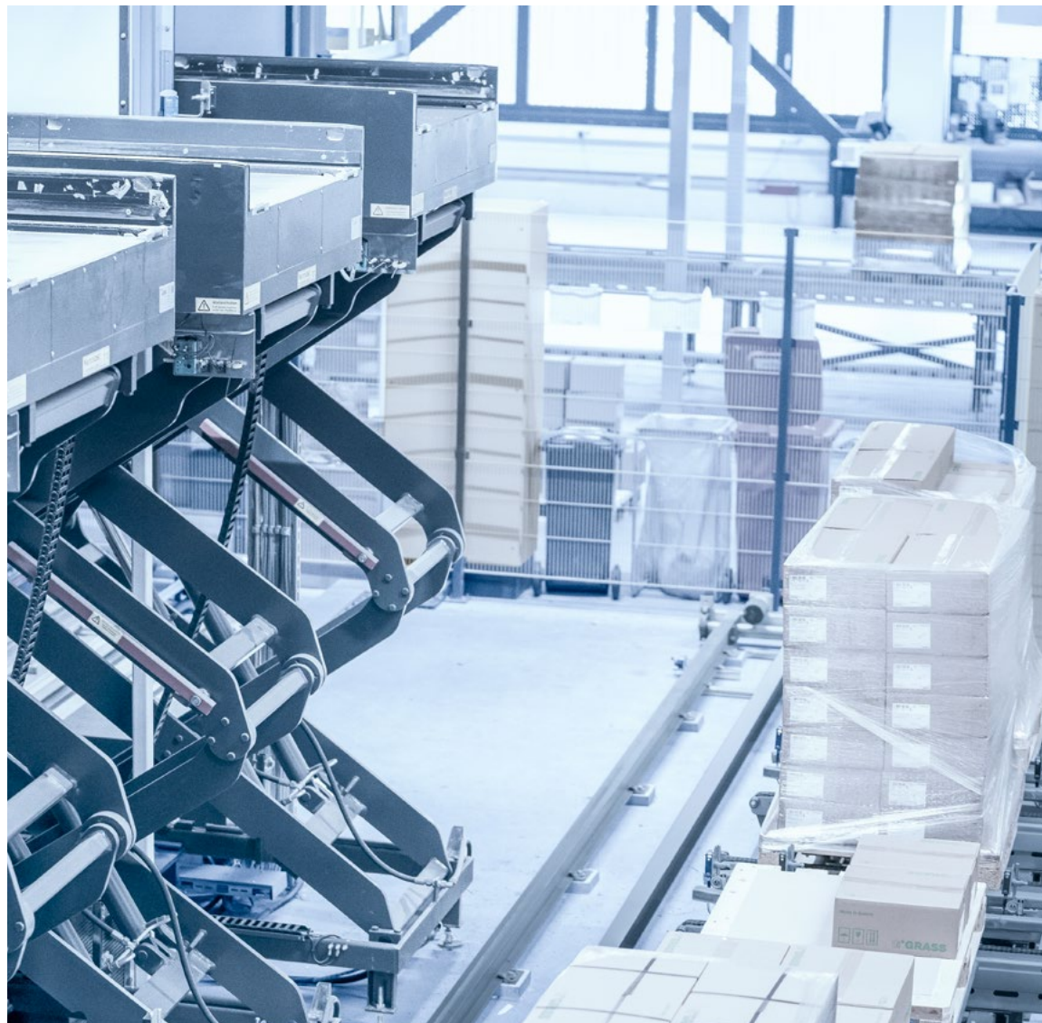
De pickplekken bevinden zich op een verhoging en krijgen vanaf de begane grond via acht schaarheftafels bronpallets aangeleverd.
