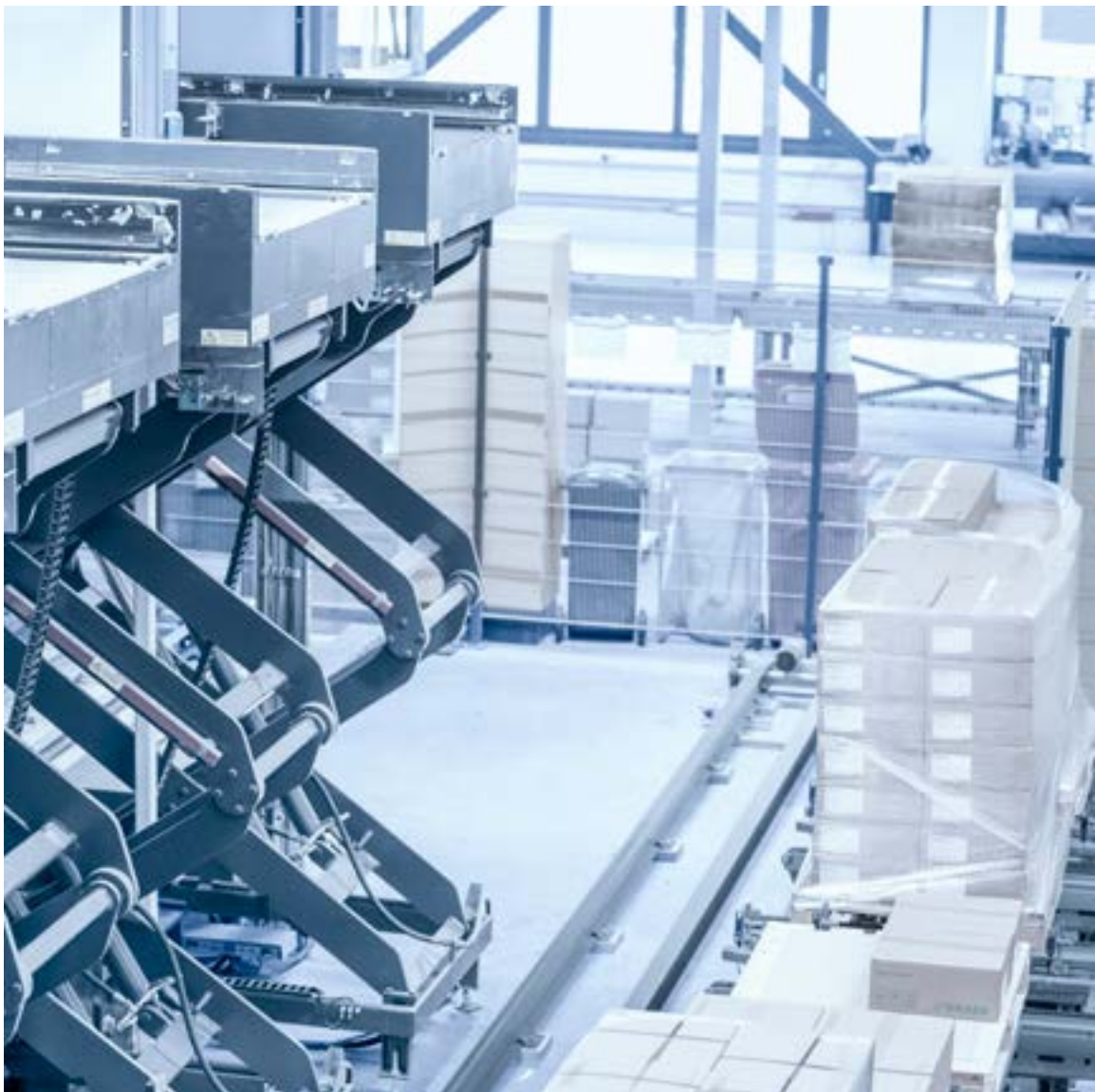
Les postes de picking se trouvent sur une plateforme alimentée en palettes sources depuis le rez-de-chaussée par huit tables élévatrices à ciseaux.
