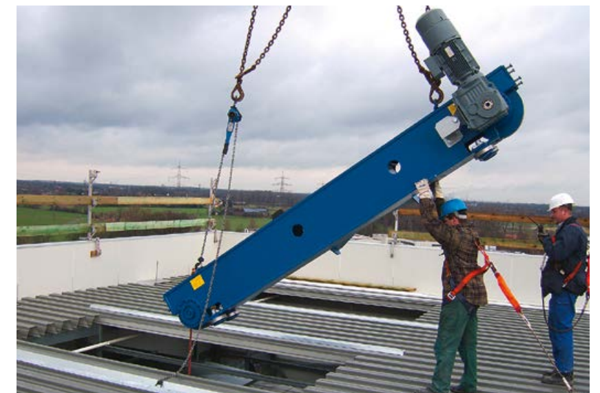
Mit modernen Komponenten werden die Anlagen auf den neuesten Stand der Technik gebracht
