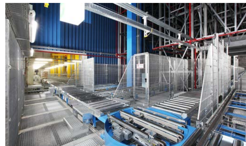
1 Kurze Wege zwischen alt und neu: Bei Fresenius Kabi verbindet eine neu installierte Fördertechnik die Bestandsanlage mit den beiden Neuanlagen
