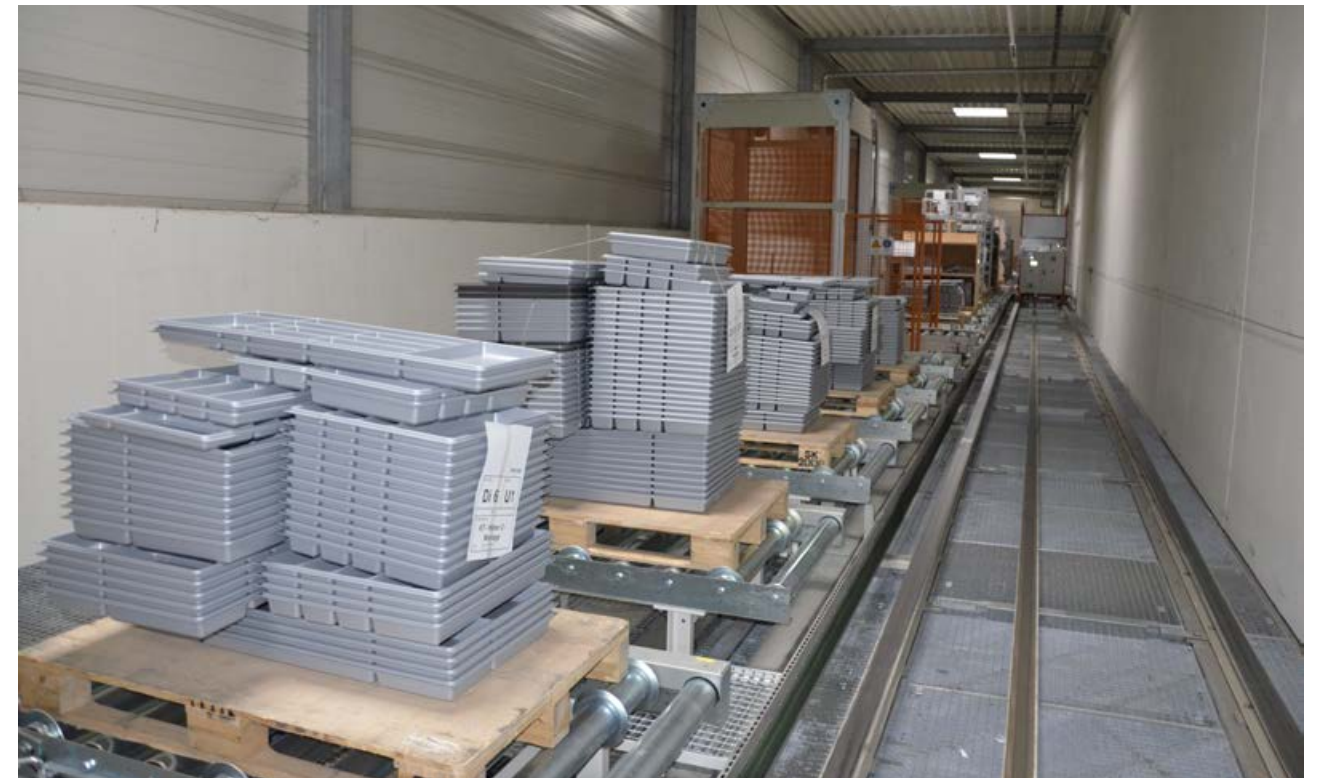
2 Im Obergeschoss des Hochregallagers wurden 34 Pufferplätze zur Versorgung der darunterliegenden Produktion eingerichtet.
