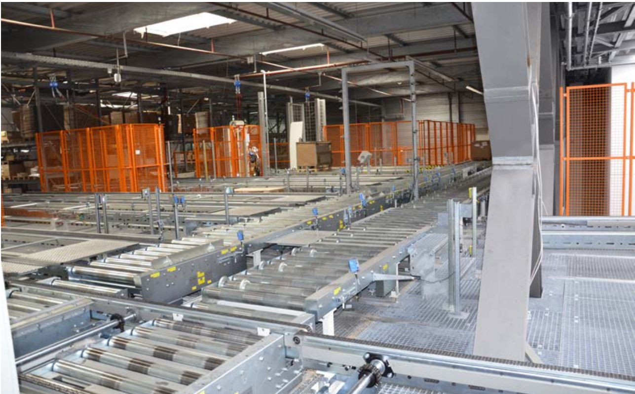
4 Mit neuer Fördertechnik wurde der umgestaltete Wareneingang an das Obergeschoss des Hochregallagers HRL 1 angebunden.
