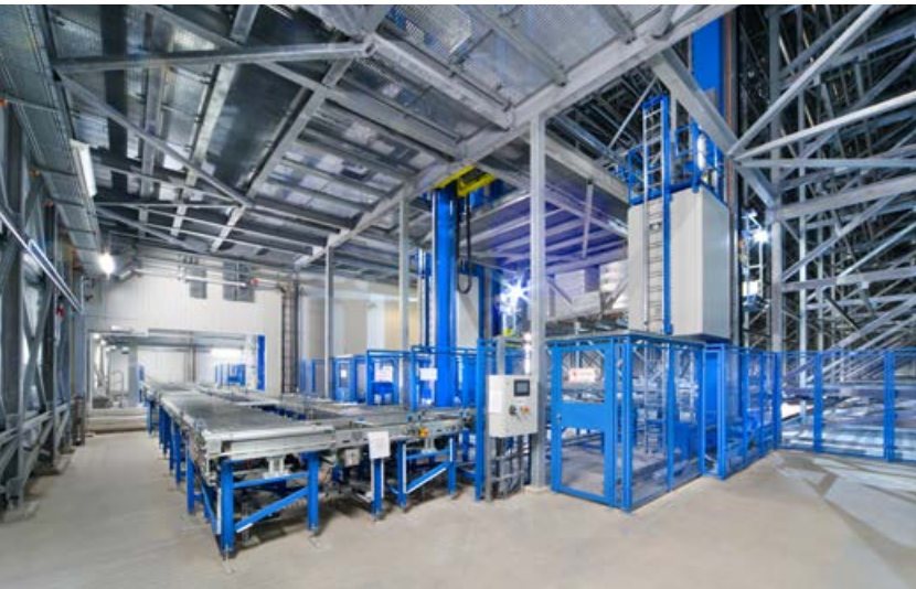
Einlager- und Auslagerebene des HRL nach der Erweiterung mit Vertikalumsetzer
