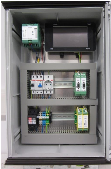
Abbildung 5: Beispiel eines Standard Lufft UMB-Schaltschranks
